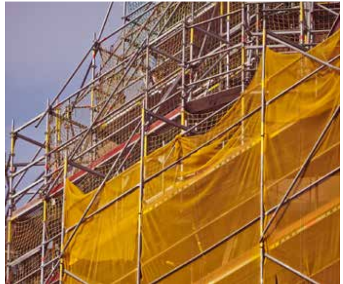
Für die Sanierung der Fassaden gab es die Möglichkeit für einen Steuerabzug
