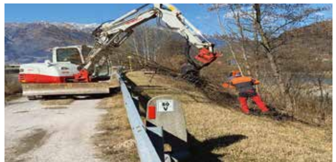
Nach einem genau definierten Pflegeplan werden regelmäßig Arbeiten an der Vegetation entlang der Flussläufe durchgeführt, um auch den Hochwasserschutz zu verbessern.
